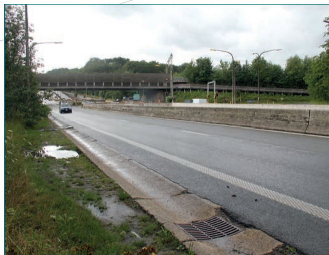
Via goten komt het regenwater rechtstreeks in de IJse terecht.
